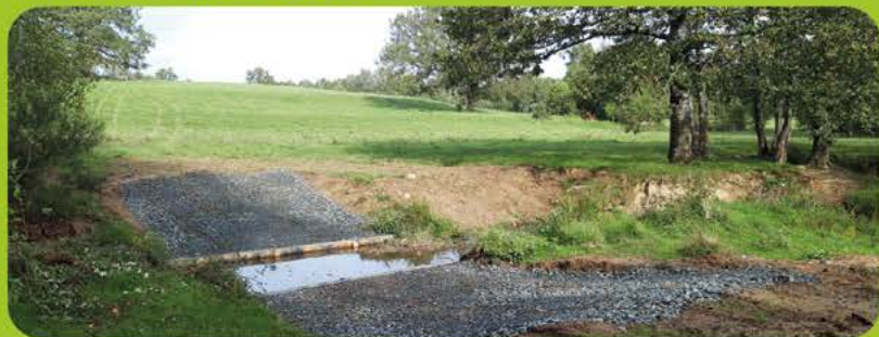
double descente aménagée (mise en défens des berges à venir) - Gorre © SMVG
